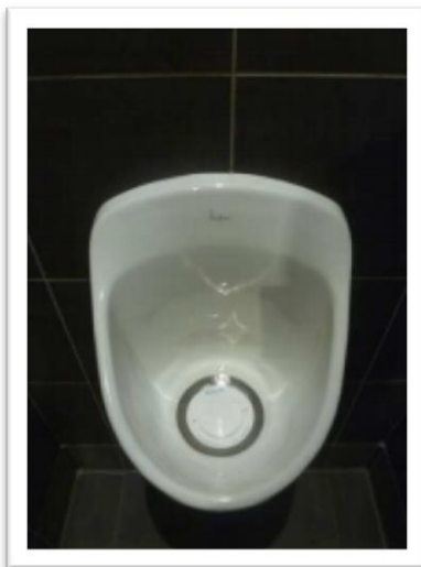
Figure 6A. Urinoir sec masculin installé à l'École Nationale des Ponts et Chaussées
